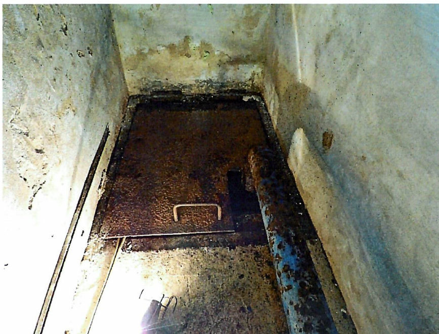
Obr. 4. Vstup do komory vodojemu zakrytý plechovým poklopem, který má okolo přívodního potrubí vyříznut otvor.
